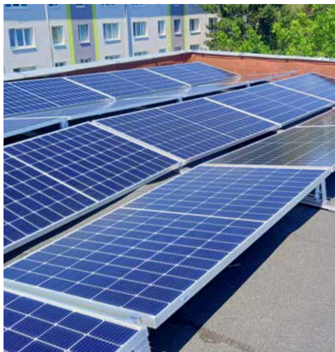
Fotovoltaické panely inštalované na streche BD
